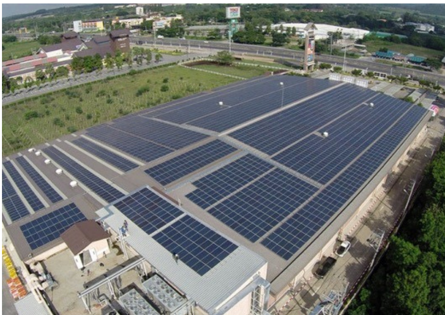
ระบบผลิตไฟฟ้าจากพลังงานแสงอาทิตย์ระบบกักเก็บพลังงาน และระบบอัดประจุ ณ สวนอุตสาหกรรมสหพัฒน์ศรีราชา จังหวัดชลบุรี ที่มา: https://www.thebangkokinsight.com/news/business/167691/
