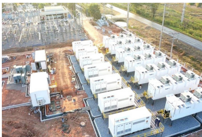
สถานีไฟฟ้าแรงสูงชัยบาดาล จังหวัดลพบุรีขนาด 37 เมกะวัตต์-ชั่วโมง ( MWh )
