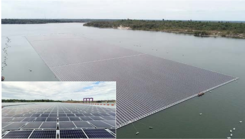
โครงการโรงไฟฟ้าโซลาร์เซลล์ลอยน้ำไฮบริด (Hydro-floating Solar Hybrid) ที่เขื่อนสิรินธร จังหวัดอุบลราชธานี ที่มา: https://ngthai.com/environment/33458/hybrid-solar-cell/
