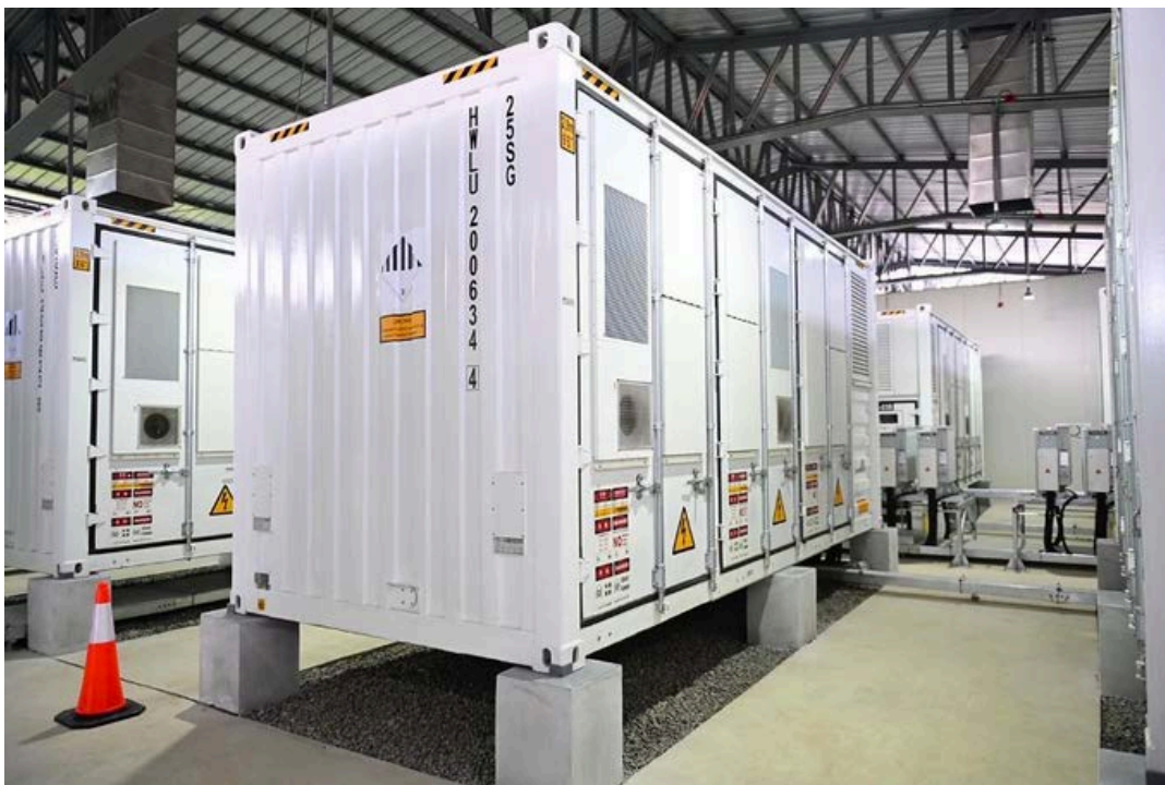
ระบบกักเก็บพลังงานด้วยแบตเตอรี่เพื่อบริหารจัดการพลังงานไฟฟ้าในพื้นที่เกาะสมุย จังหวัดสุราษฎร์ธานี ที่มา: https://www.thairath.co.th/news/local/2808100
